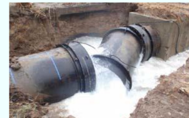
水道管φ2400mmの抜け出し被害
