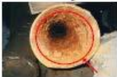
—錆が付着した水道管の内部—
